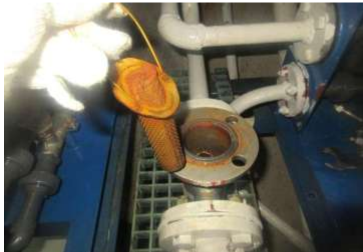
Gambar Basket strainer yang tersumbat dan kotor Sumber: dokumentasi penulis (2025)
